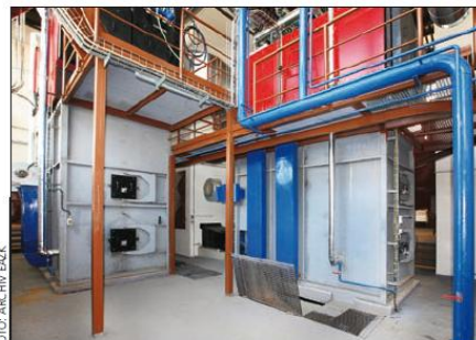
V rekonstruovaném centrálním zdroji tepla v Brumově-Bylnici fungují i dva kotle na biomasu o výkonu 1 a 2 MW.
